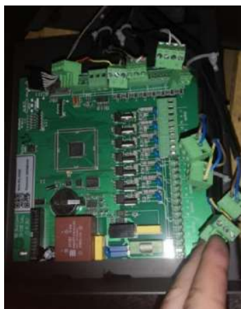
Photo 2: Débrancher les "blocs verts"
